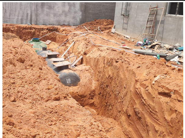
一体化污水处理设施
