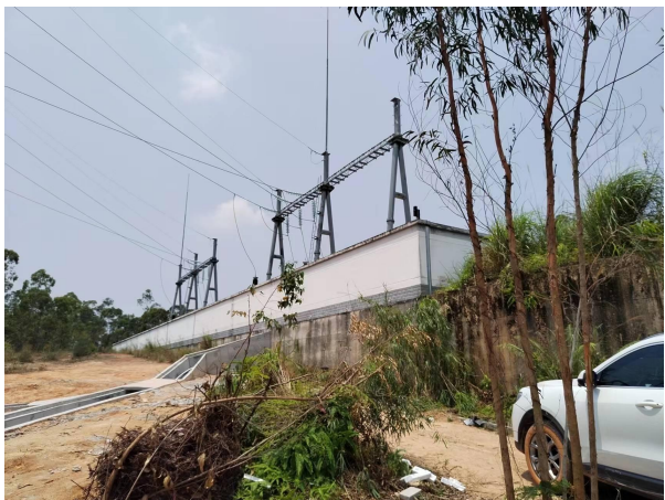
长山 110kV 变电站
